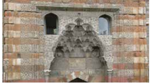
Tokat Muiniddin Pervane Darüşşifası taçkapısında müze sürecindeki tahrip durumu (ggc.arş. 2018)
