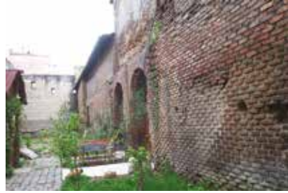
Sivas İzzeddin Keykavus I. Darüşşifası, günümüzde işlev değişimi için avlunun betonarme bir yapıya dönüştürülmesi ve ilk yapıya ait (12. yüzyıl) kalıntı ve doku belge varlığının yok edilmesi (ggc.arş. 2018)
